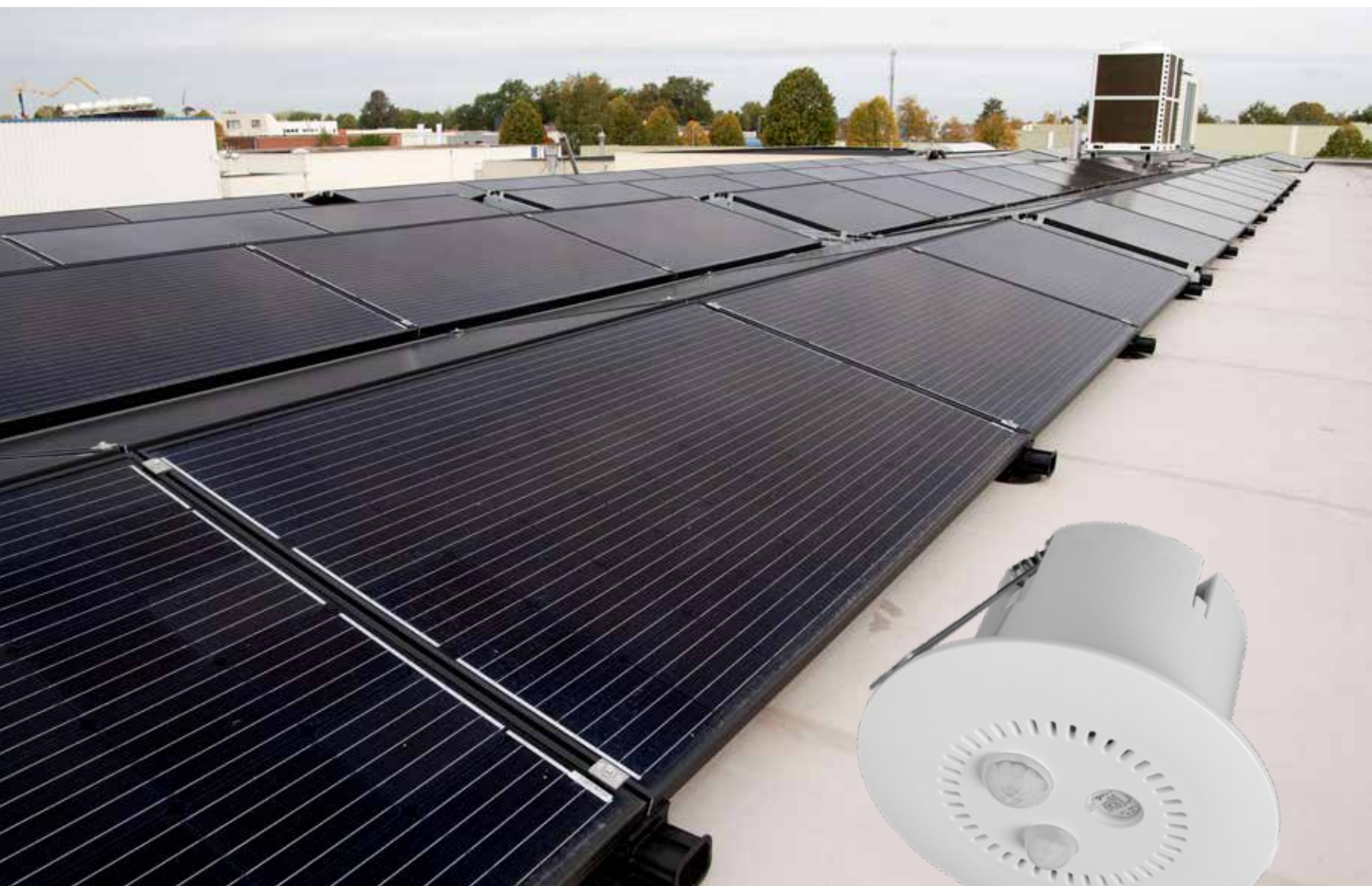
Het complete dak van Wassink Installatie is voorzien van pv-panelen.
