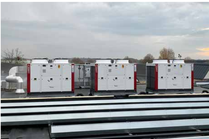
De vloerverwarming in de kantoorruimtes van Hesselink Koffie wordt gevoed door drie elektrisch aangedreven lucht/water-warmtepompen op het dak.
