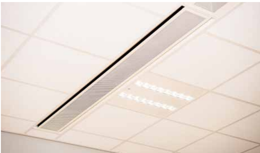
Als afgiftesysteem in de kantoren van Wassink Installatie is gekozen voor inductie-units.
